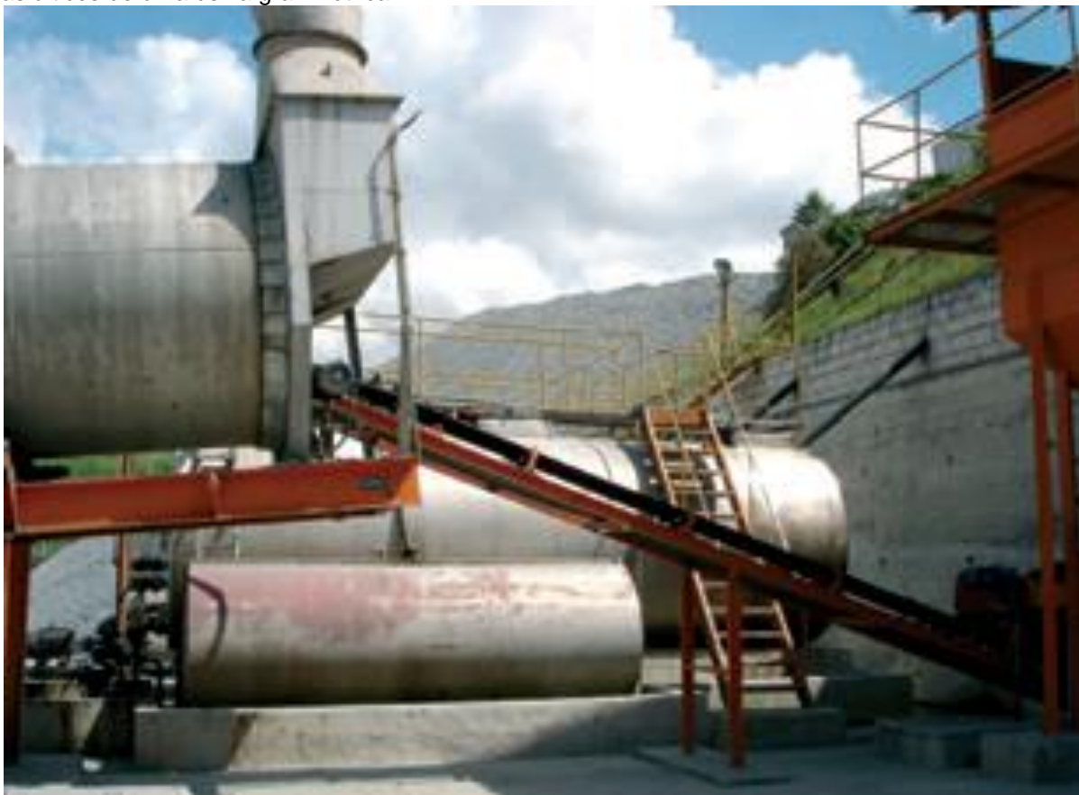
Figura 6: Exemplo de tanques horizontais para armazenamento com aquecimento de ligantes asfálticos de uma usina gravimétrica
