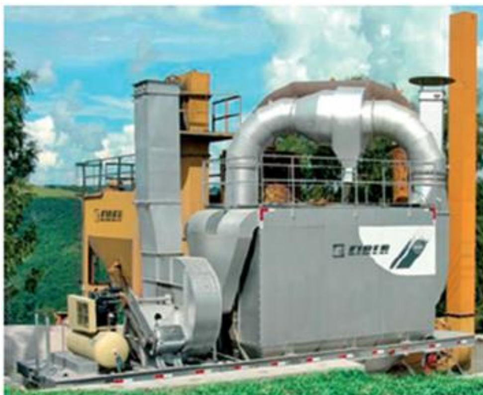
Figura 13 - Exemplo de sistema de coletores de pó
