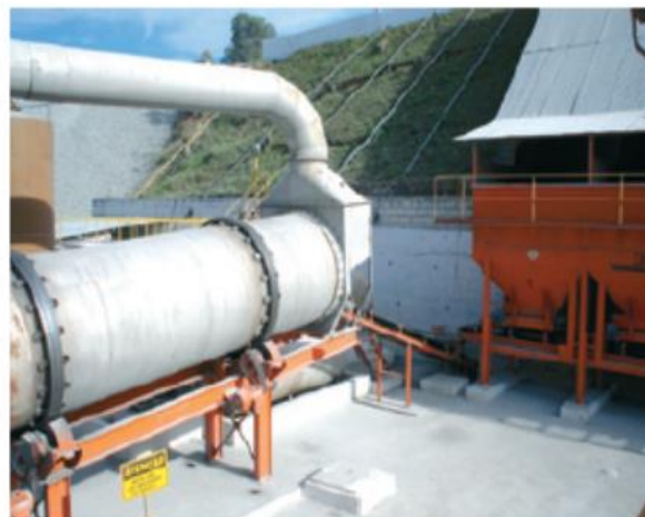
(b) Secador de agregados com ventilador de exaustão
